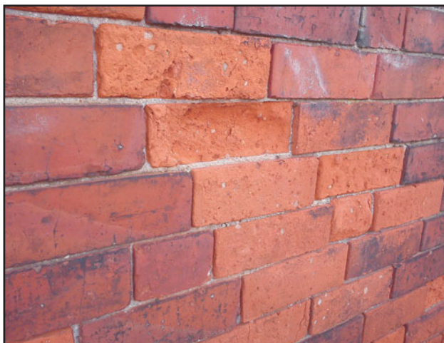
Рис. 267 Раскрошившаяся кирпичная кладка.
