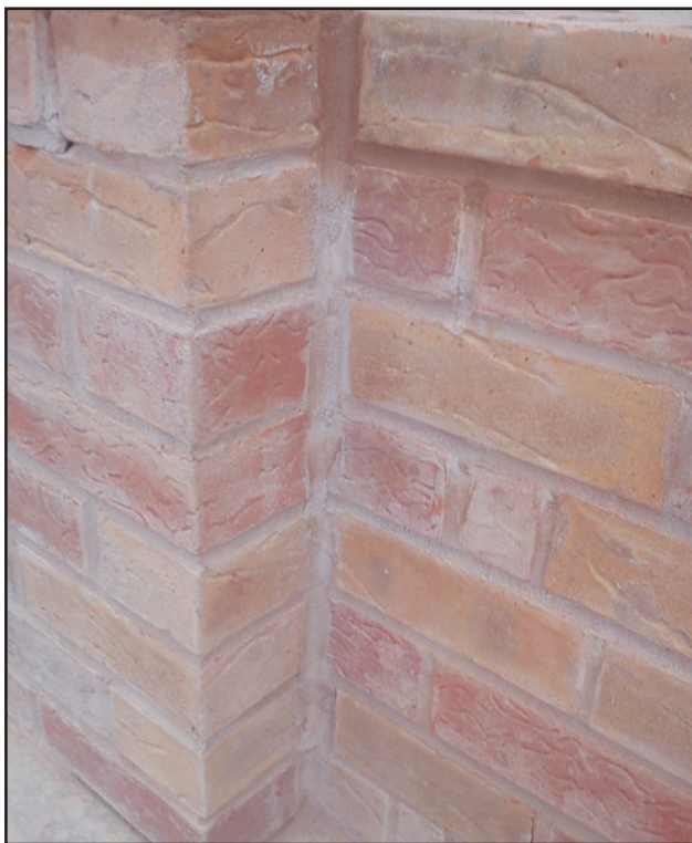
Рис. 166 Плохо выполненный полукруглый шов во внутреннем углу.
