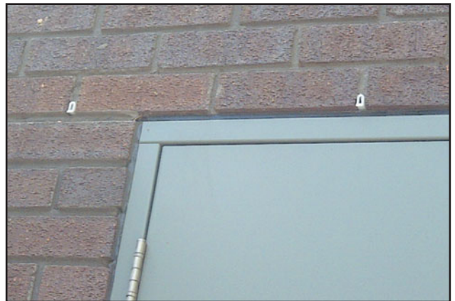
Рис. 191 Пластмассовые дренажные трубки, установленные над дверным проемом.
