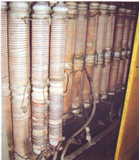
Рис. 5. Повреждения демпферных резисторов электровоза ВЛ11М
