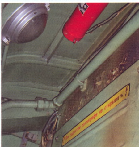
Рис. 1. Шахта пусковых резисторов электровоза ЧС2К со следами нагрева
