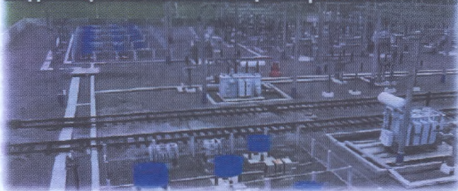
внедрение устройств компенсации реактивной мощности на тяговых подстанциях и постах секционирования
