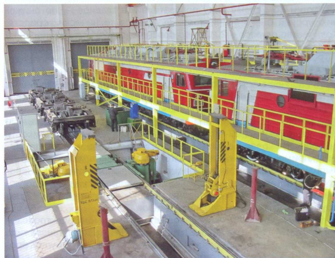
Участок по ремонту электровозов ЭП1 в объеме ТР-1, ТР-2 в депо Саратов
