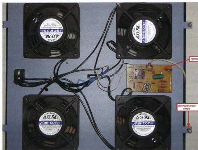
Рис. 1. Установленные в серверном шкафу вентиляторы с устройством электронного терморегулятора оборотов (вид сверху)
