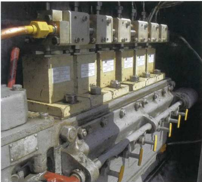
Рис. 4. Установка электроуправляемых топливных насосов на ТНВД
