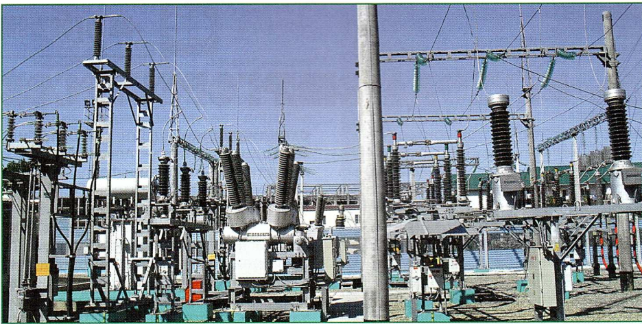
Открытое распределительное устройство 110 кВ подстанции Адлер
