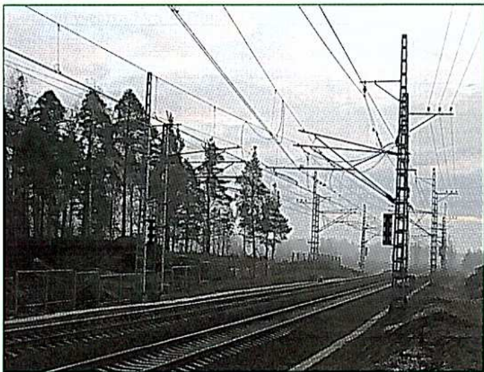
Участок контактной сети КС-200 линии Санкт-Петербург — Бусловская
