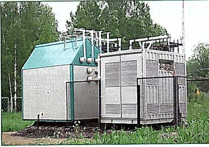
Вольтодобавочное устройство на участке Санкт-Петербург — Москва
