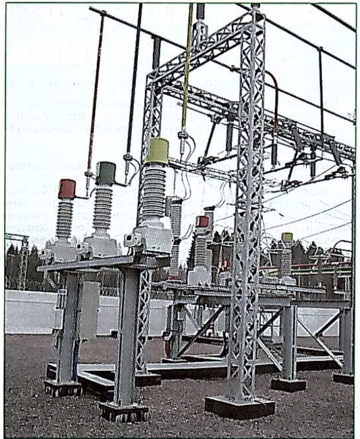
Тяговая подстанция Лейпясую питает скоростной участок Санкт-Петербург — Бусловская
