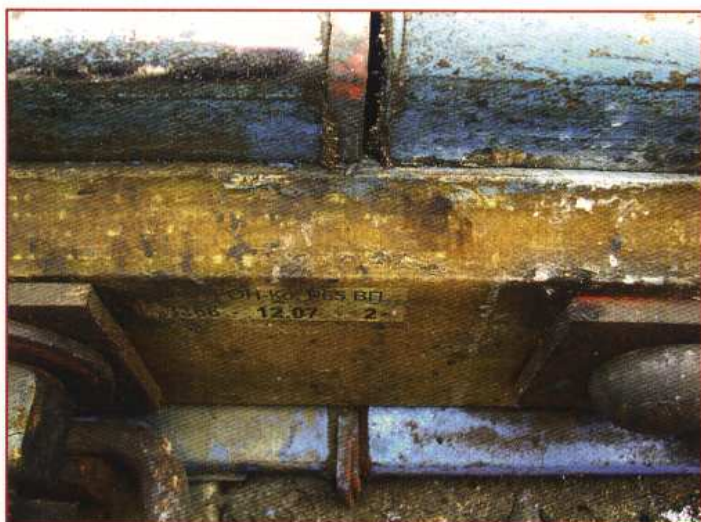
Накапливающаяся от трения колеса и тормозной колодки металлическая микростружка способна вызвать перекрытие изолирующего стыка, спровоцировать перекрытие сигнала и задержку поездов
