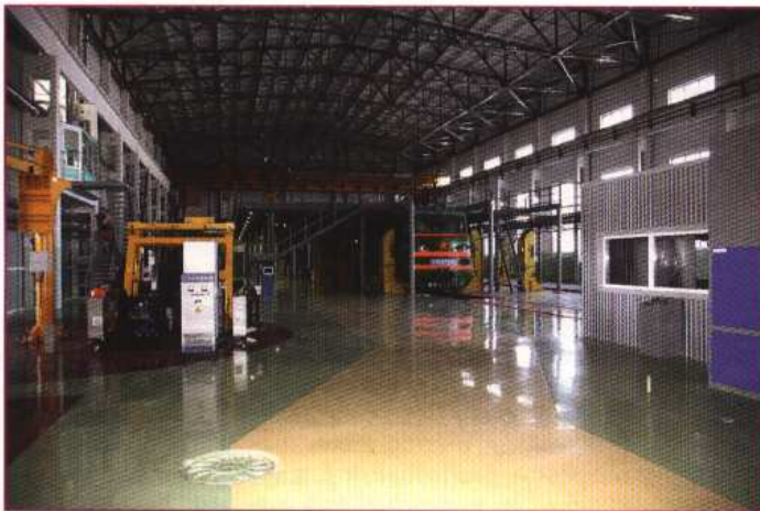
В новом цехе ТР-3 установлено современное высокопроизводительное оборудование
