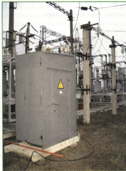
Рис. 1. На переднем плане шкаф УЗС-1, установленный на тяговой подстанции
