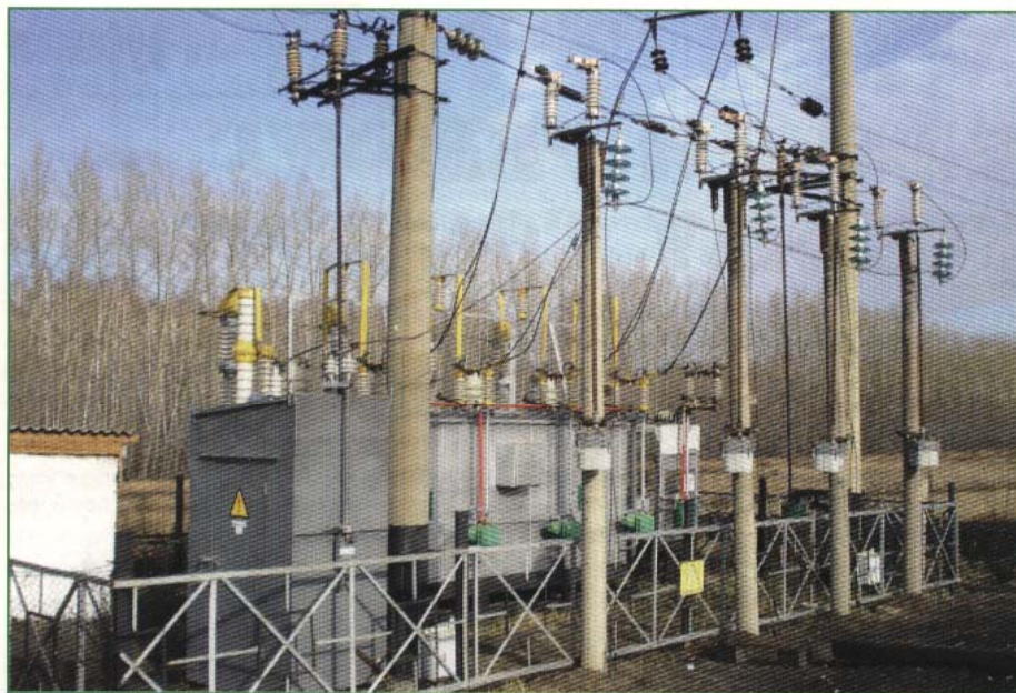
Рис. 3. УЗС-1, подключенное на посту секционирования
