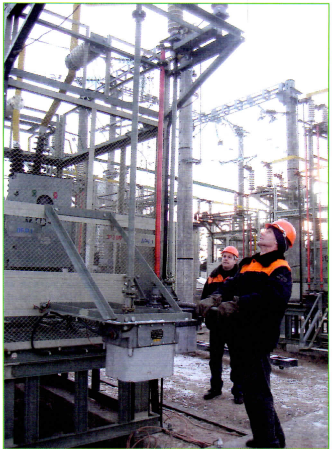
Рис. 4. Подстанция Ладва питает участок Идель — Свирь
