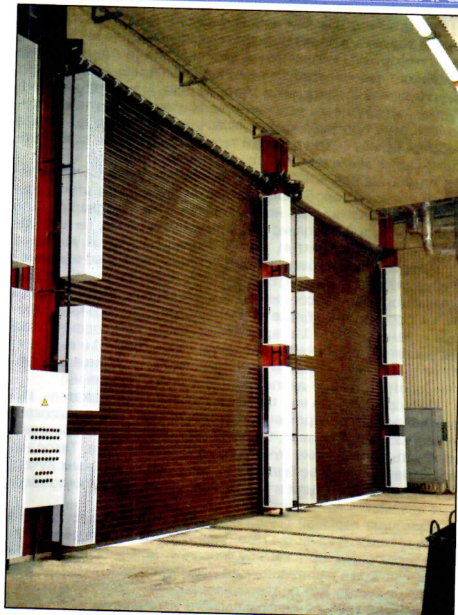
Рис. 3. Воздушные завесы серии «Универсал ПРО» на воротах цеха ТР-1 депо Волховстрой I
